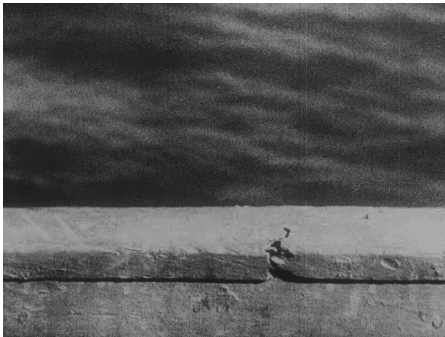
Figura 8. Rachadura. Fonte: Limite (1931).
